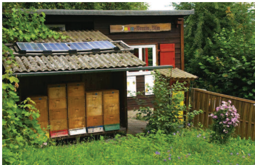
Photovoltaik-Insellösungen werden unabhängig vom Netz betrieben und eignen sich daher bestens für die Energieversorgung abgelegener Stellen, wie z. B. ein Bienenhaus.
